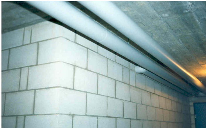
Bild 2: Rohrleitungsanlage mit Isolierummantelung „ISOGENOPAK 350 SE“ (Baustoffklasse B1) auf nichtbrennbaren Dämmstoffen in einem Kellerraum
